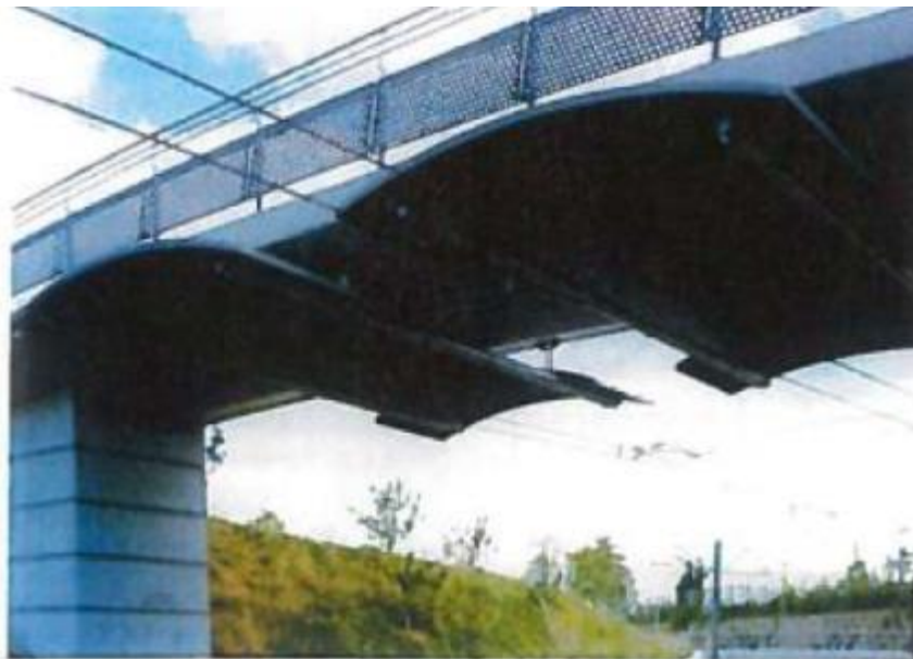
Kuva 1 Ylikulkusilta, jossa on sillan pohjassa eristelevy
